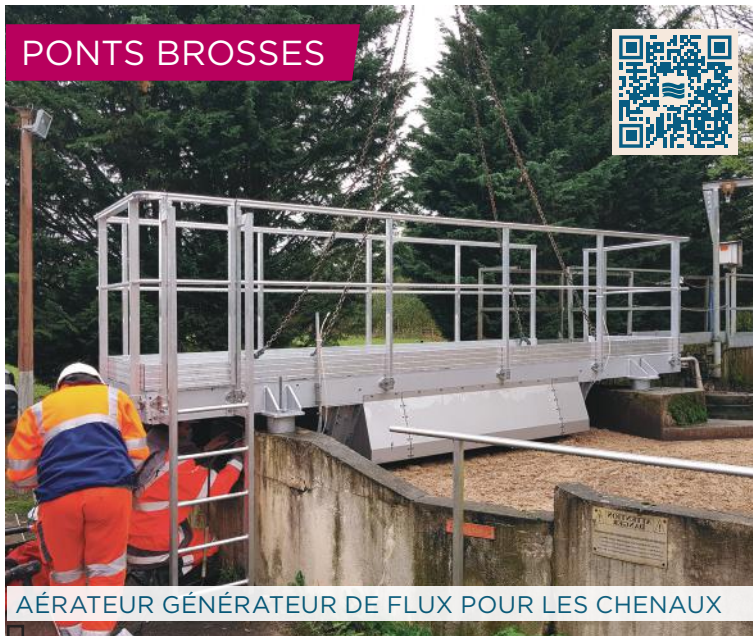
Aération de surface
